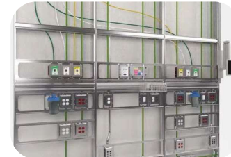
Mur de tête de lit médicalisé
